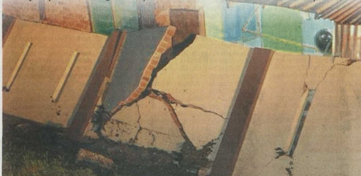
KEROSAKAN teruk akibat kejadian ribut di Denai Rover di Hutan Simpan Bukit Lagong, Selangor, baru-baru ini.
